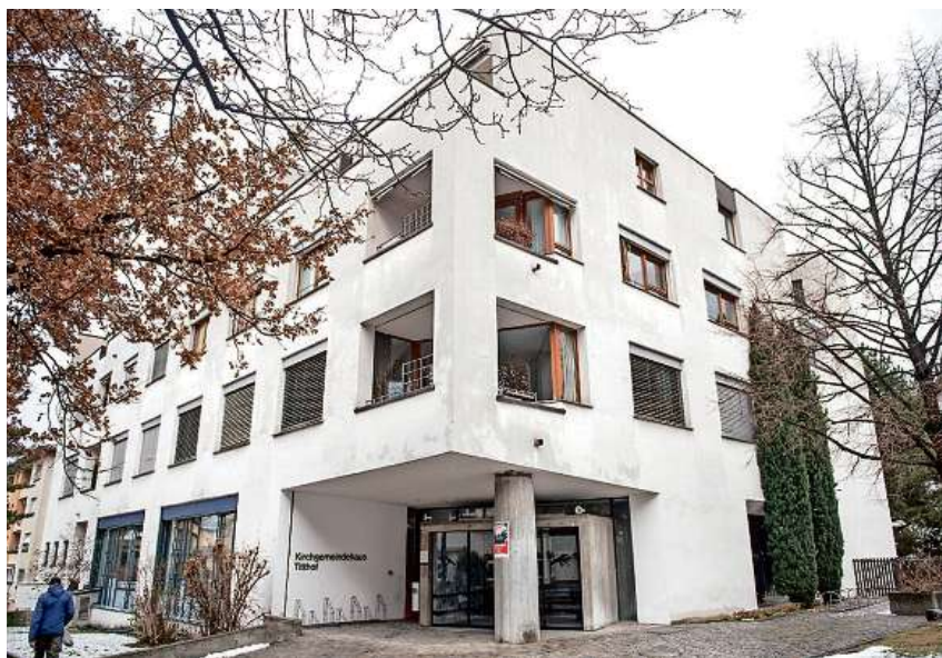
Grau statt weiss: Die Fassade und auch der Innenausbau des Kirchgemeindehauses Titthof müssen dringend saniert werden.
