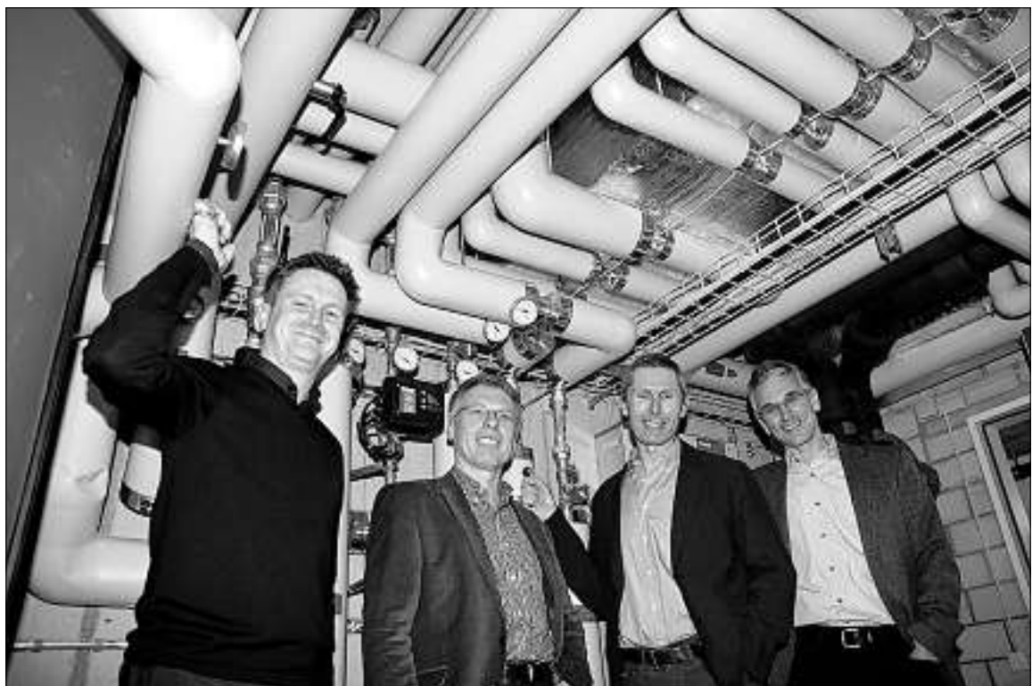
Minergie-P-Eco ist Teamarbeit: Michael Schumacher (Architekt), Stefan Balzer (Haustechnik), Erik Bernhard (Energiekonzept) und Michael Zindel (Baumeister, v. l.) in der Energiezentrale. (nw)
